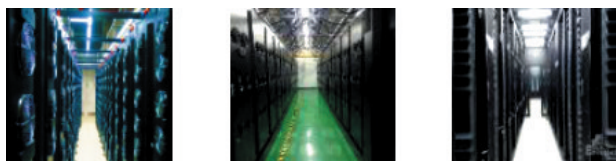
图6 热管背板、水冷前门、列间空调新型末端
