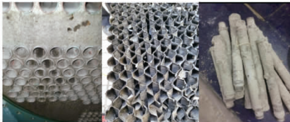
图1 冷凝器、冷却塔填料、砂滤布水器结垢情况
